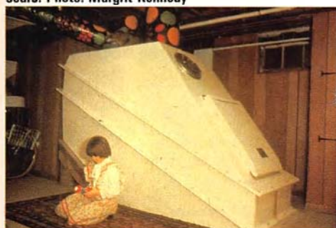
Clivus-Multrum-Humus-Toilette. Tank im Keller. Photo: Declan Kennedy
